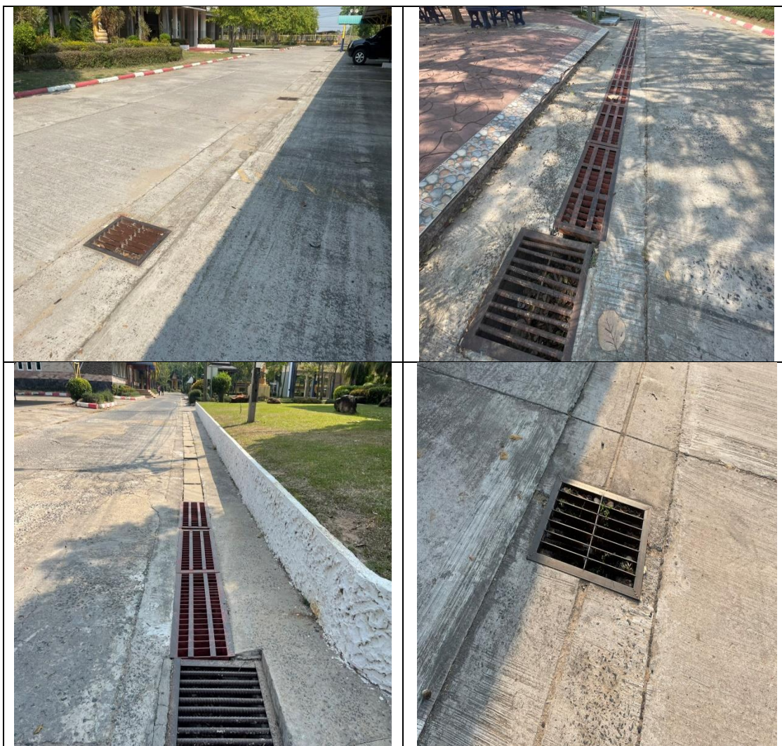
ภาพที่ ๖ แนวทางระบายน้ำตามแนวถนนและอาคารต่างๆ มีฝาปิดมิดชิดเพื่อความปลอดภัยของผู้เรียน
